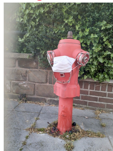
Bouche d'incendie au temps du confinement. Photo CV.
